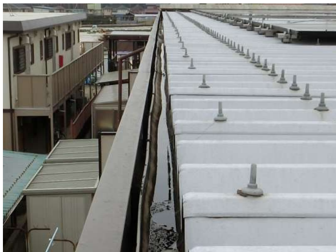
軒樋 湾曲及び勾配不良
