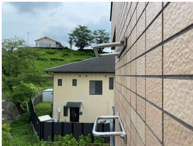
強風により破損
