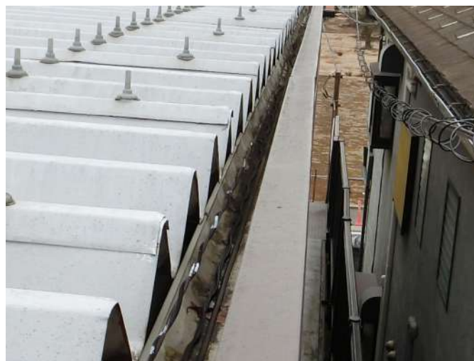
軒樋 湾曲及び勾配不良
