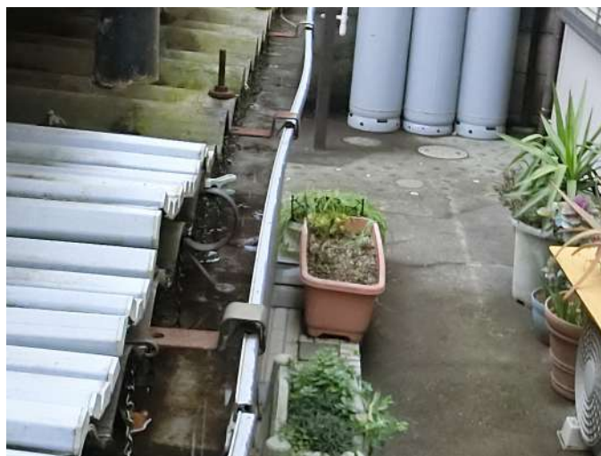
軒樋 湾曲及び勾配不良
