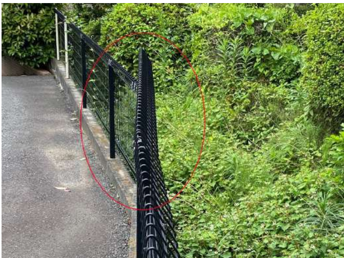
強風によりフェンスの破損
