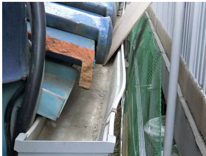
軒樋 湾曲及び勾配不良
