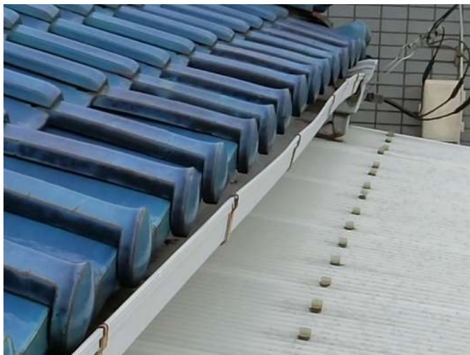
軒樋 湾曲及び勾配不良
