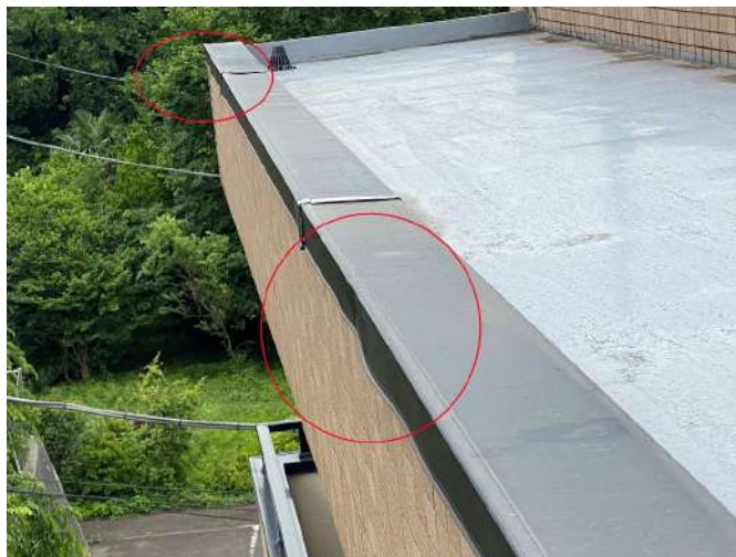
笠木板金の破損
