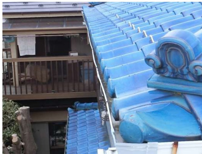
軒樋 湾曲及び勾配不良
